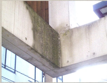
梁端部。コンクリートの表面に黒カビや苔が集中 して発生している。
