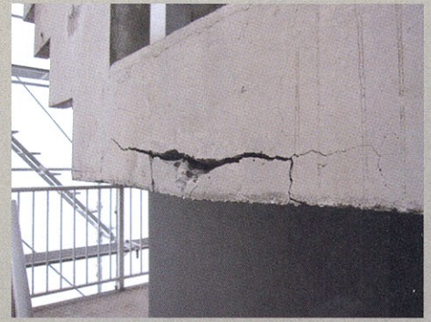
鉄筋が錆びて爆裂している様子。
