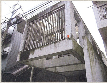
築10年経過のコンクリート打ち放し建造物。 黒カビと汚垂れによる汚れが顕著。
