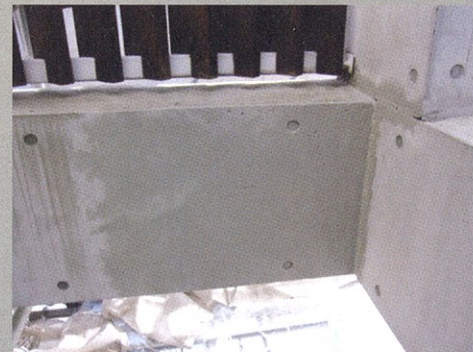
コンクリートの補修(改質)のため、Sクリートアッ プを塗布後、Sクリートクラック(超微粒子セメント) にて、表面被覆補修をする。Sクリートアップの効 果にて、強靱な接着性が保たれる。
